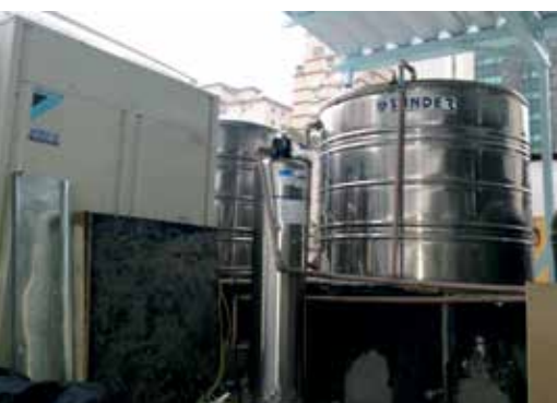
Sistema de ar condicionado VRF e reservatório pluvial
